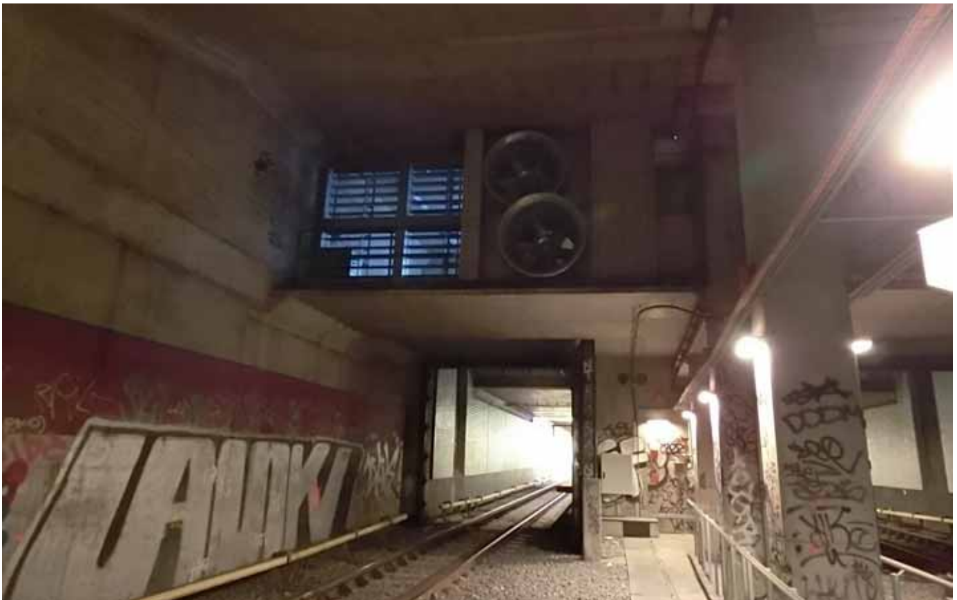
Zowel de tunnelbuis als de tussenliggende stations zijn voorzien van een mechanische RWA-installatie.
