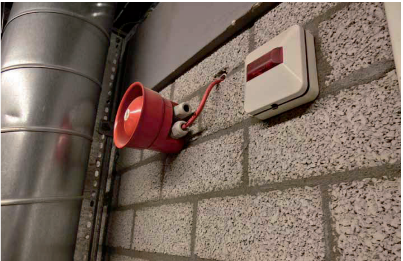
De ontruimingsalarminstallatie alarmeert intern met licht- of geluidsignalen.
